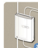
Beispiel 3: LWL-Steigleitung (Riser Cable) über den PBA48 geführt
